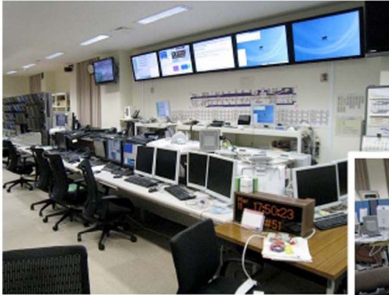
sala di controllo principale
