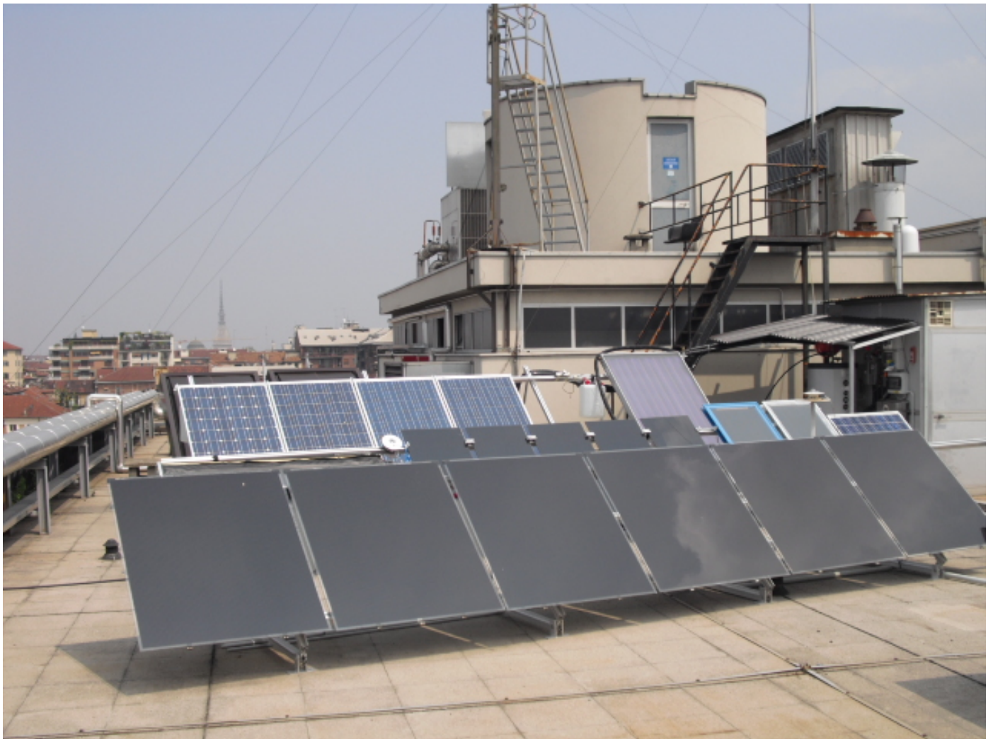
Figura D-1: Fotografia dell'impianto
