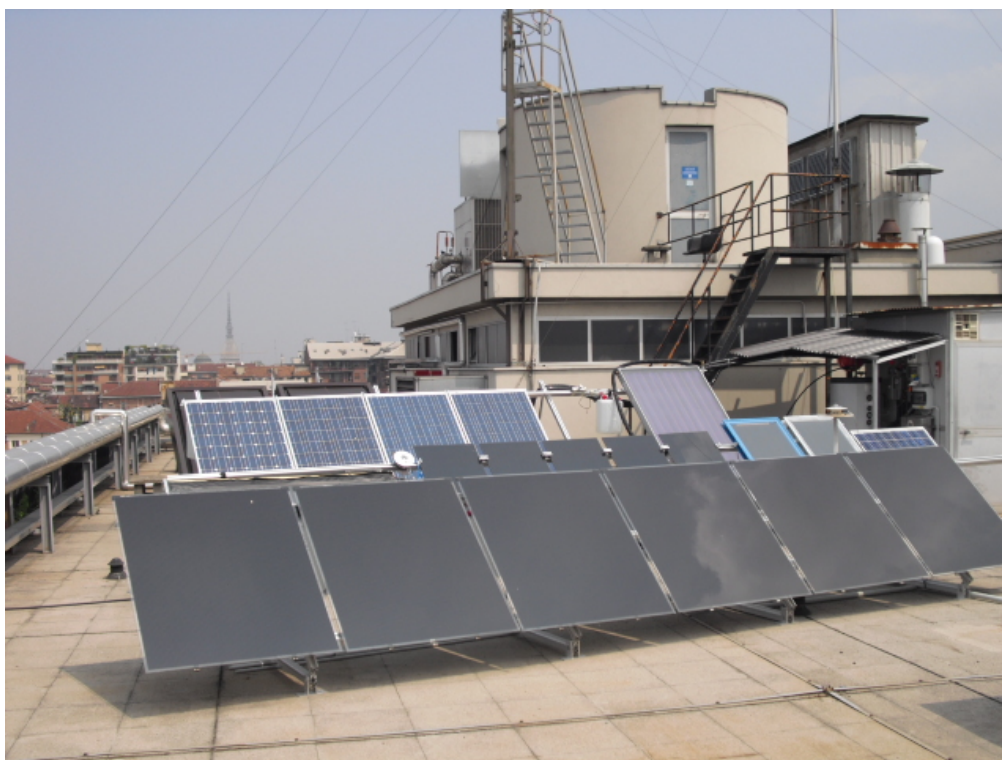
Figura 1: Fotografia del Minilab solare
